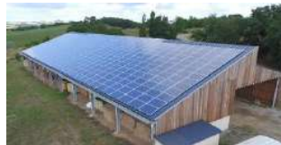
Hangar photovoltaïque à Samatan © EDF ENR – JMV
