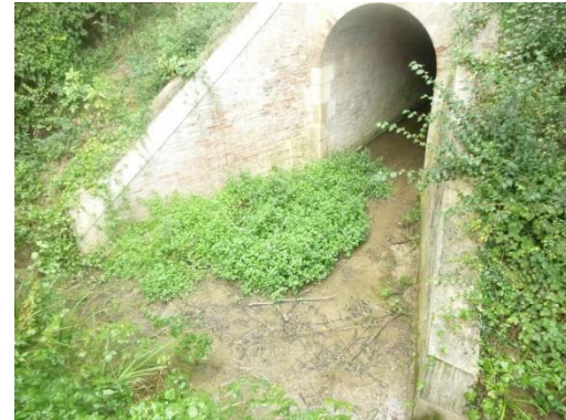
Confluence ruisseau de la Passade et ruisseau d'En Bon au niveau de la RD121
